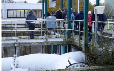
Techniek afvalwaterzuivering (TAZ)
